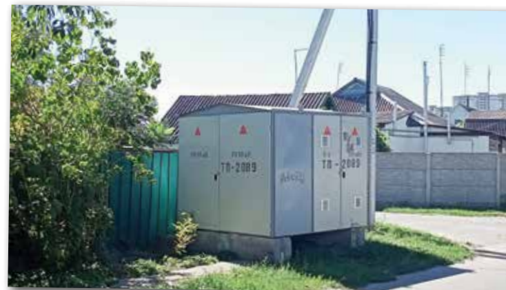
• Встановлено чотири нові трансформаторні підстанції.
